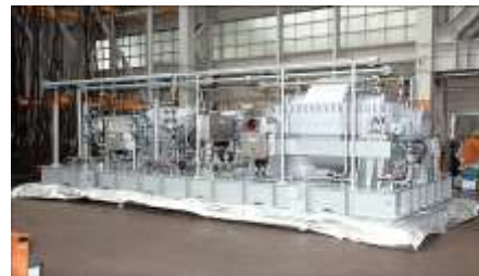
Hệ thống theo dõi bộ nén CO 2 (Công ty CP Phân bón Dầu khí Cà Mau)
